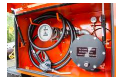
Узел выдачи топлива
